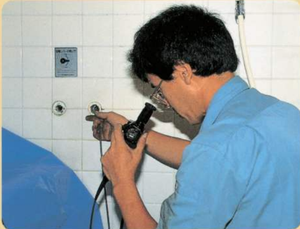
●内視鏡による管内部の腐食状況の調査。
