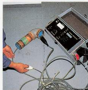
塗膜硬化後、ホリデーディテクターでパイプ内部前面のピンホールの有無を検査します。
